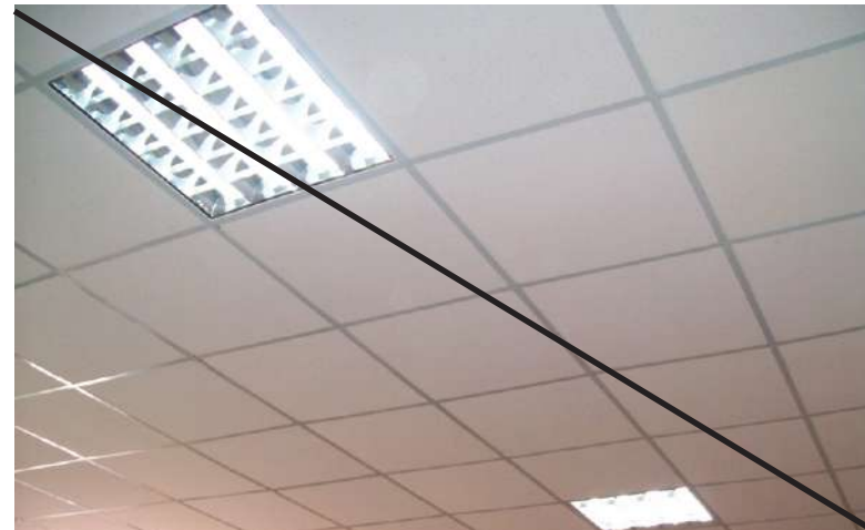
Плохо Открытые направляющие
